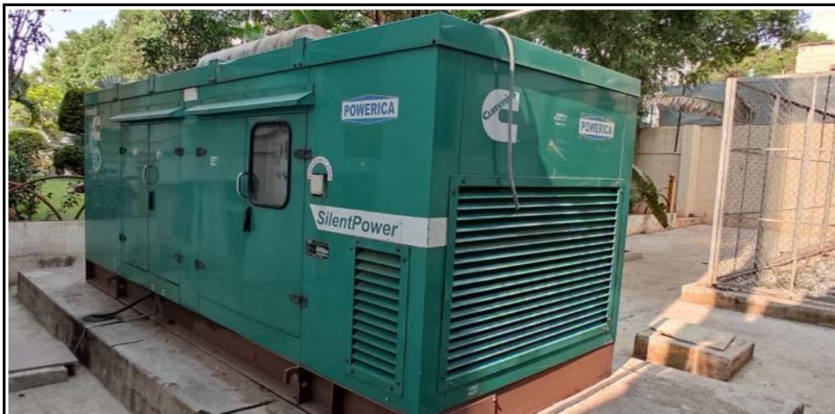
DG Set (250 KVA)
